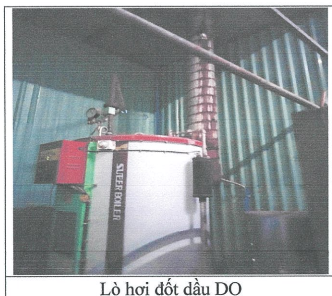
Hình ảnh khu vực lò hơi đốt dầu DO:
